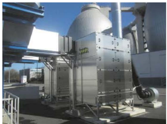
Neutralox Photoionisation auf der Kläranlage Emscher Mündung
